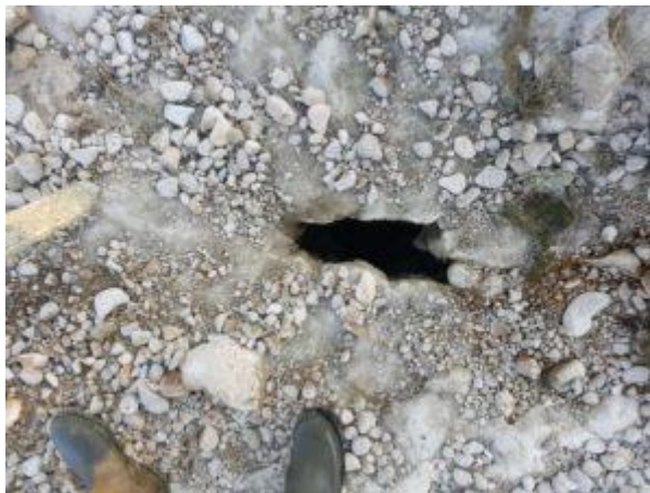
Siphon dans l'assec du Doubs à Maisons-du-Bois
