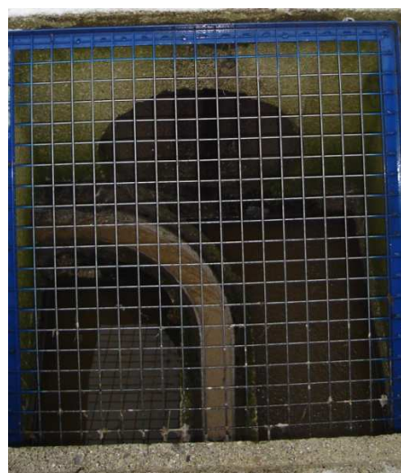
Détail du dégrilleur.
