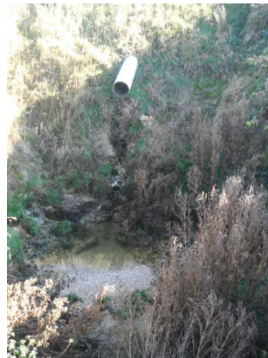
Détail sur le rejet de la STEP.
